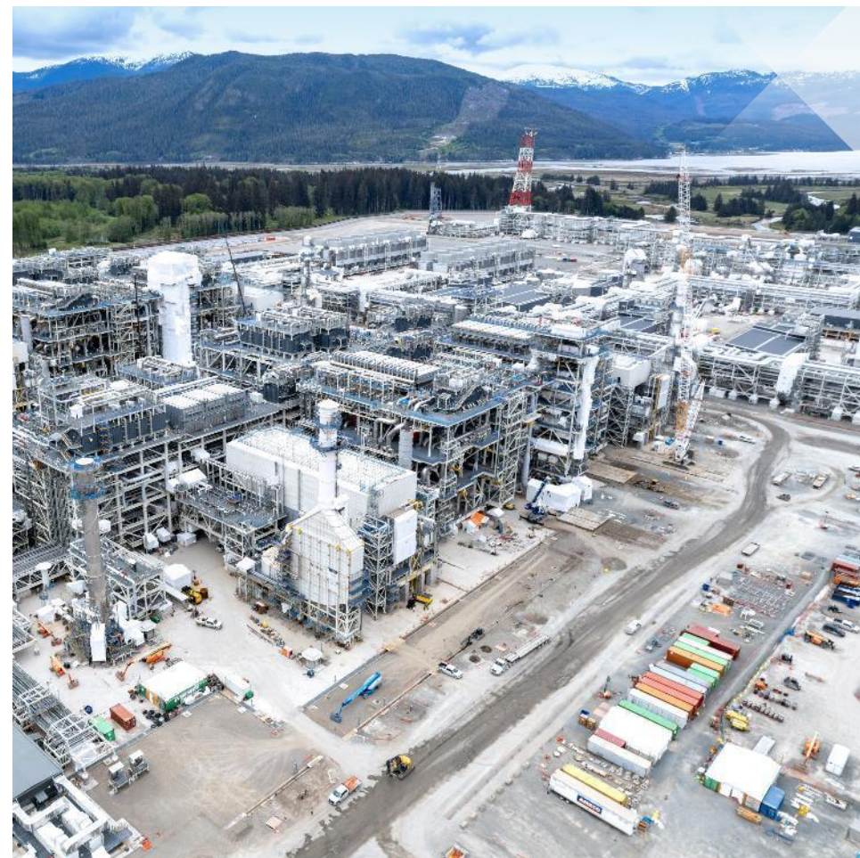
LNG CANADA EXPORT FACILITY // KITIMAT, B.C., CANADA
