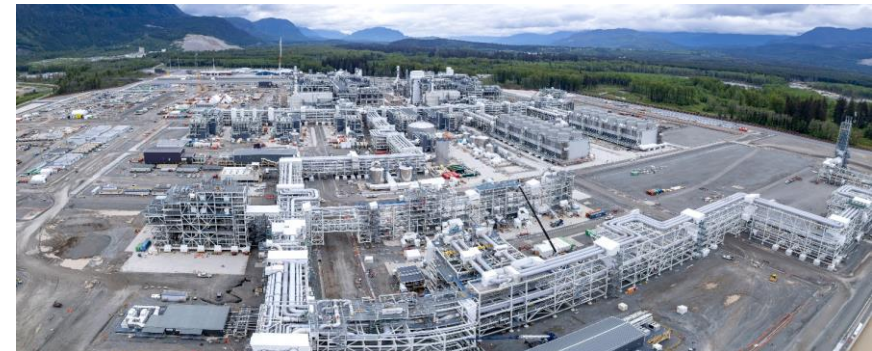
LNG CANADA EXPORT FACILITY // KITIMAT, B.C., CANADA
